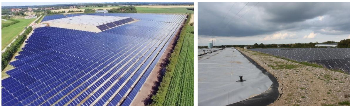
Pav. 36: Saulės šilumos kolektorių laukas su PIT tipo sezonine ŠAT prijungtas prie CŠT tinklo, Gram, Danija (Šaltinis: Gram Fjernwärme, D. Rutz)
