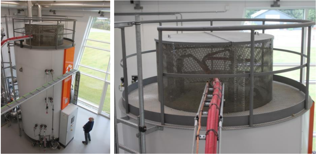
Pav. 51: Elektrodinis 10 MW galios ir 14,4 m 3 tūrio katilas įrengtas saulės kolektorių sistemoje, Gram, Danija (Šaltinis: D. Rutz)
