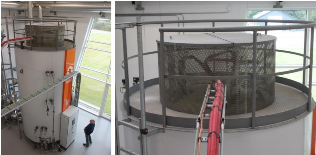
Slika 42: Elektroodni bojler od 10 MW i 14,4 m 3 kapaciteta solarne elektrane u Gramu, Danska (Izvor: D. Rutz)
