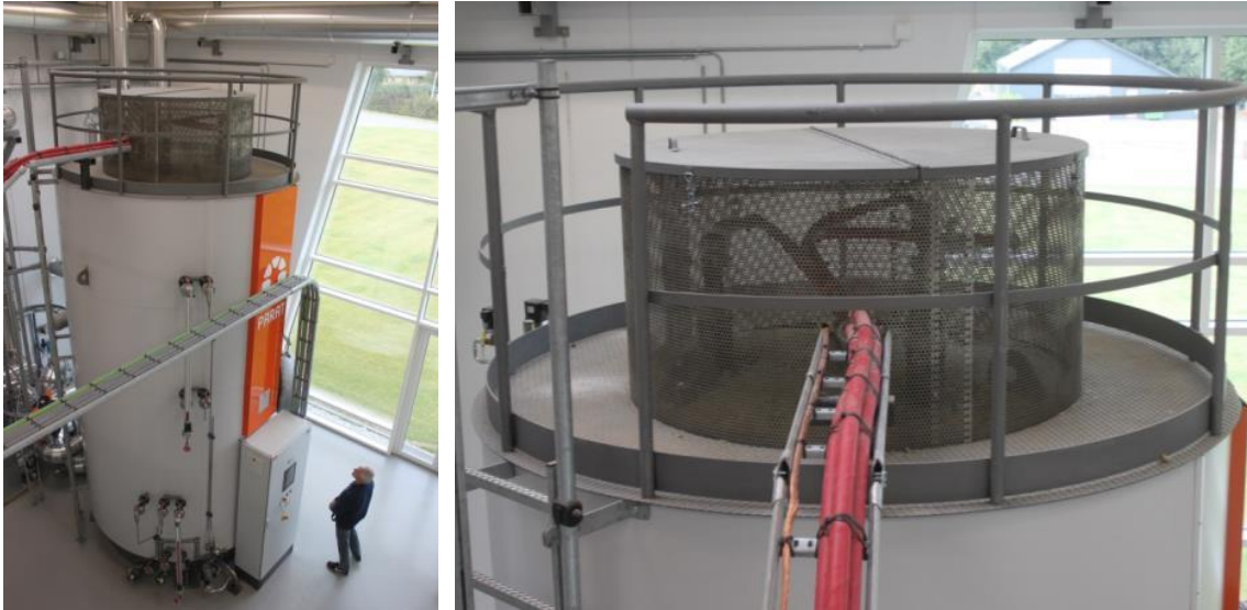
Figur 51: Elkedel på 10 MW og 14,4 m 3 kapacitet på solvarmeanlægget i Gram, Danmark (Kilde: D. Rutz)
