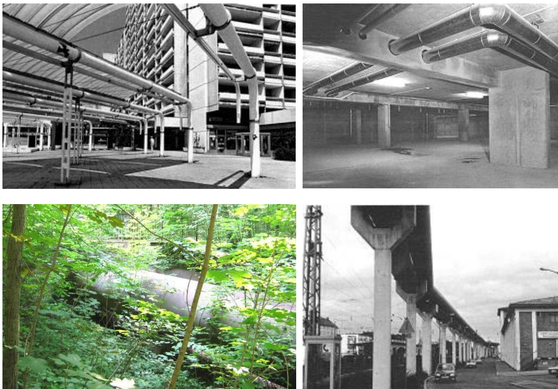
Figur 31: Eksempler på eleverede og terrænnære rørledninger (Kilde: AGFW, 1987)
