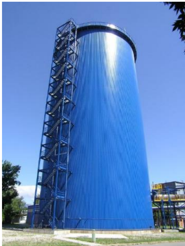
Figur 55: Ikke tryksat varmelager til fjernvarmesystemet i Zagreb (kilde: www.pogledaj.to )
