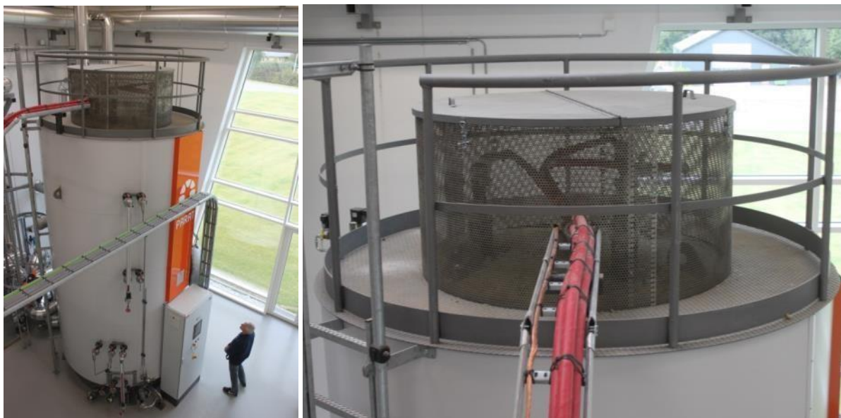
Figura 51: Caldaia a elettrodi da 10 MW e 14,4 m 3 di capacità, centrale di teleriscaldamento solare di Gram, in Danimarca (Fonte: D. Rutz)
