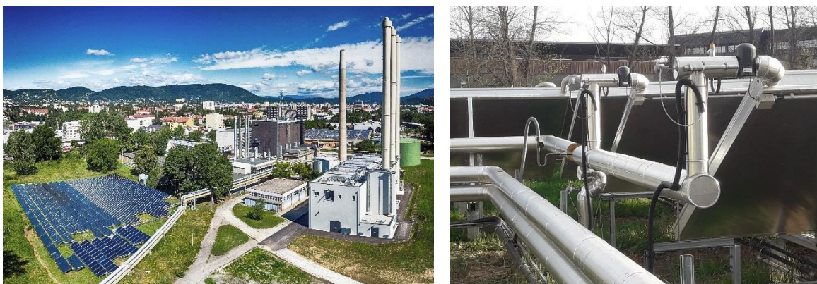
Figura 35: Campo con collettori solari termici a Graz, in Austria, che alimenta la rete di teleriscaldamento della città (Fonti: sinistra: SOLID; destra: D. Rutz)
